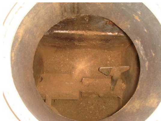
▲發酵槽加熱、攪拌、濾油、脫水、發酵、分解等一貫自動化作業
