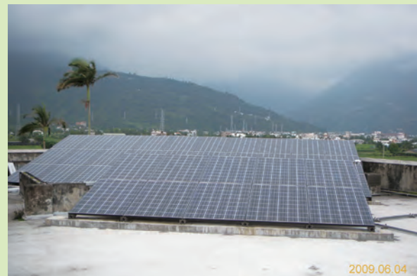
▲圖一、設置於大樓樓頂的太陽能發電系統
